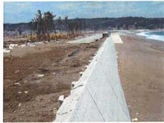
写真 2.2 波返しのみ被災し、天端被覆工、裏のり被覆工が流失している
