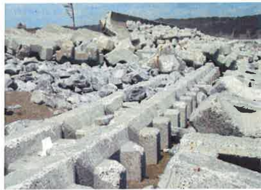
写真 2.3 根固めブロックの衝撃による堤の破壊
