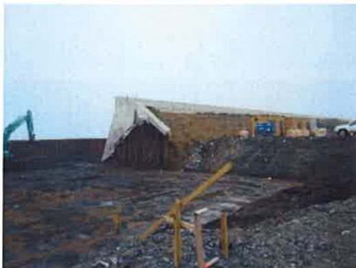
写真 2.6 第2区間(波返しが損壊等の区間)の末端ここを境に第3区間(ほぼ全壊の区間)となる。
